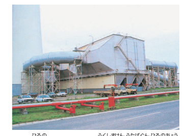
広野火力発電所(福島県双葉郡広野町)
