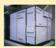
燃料電池の発電設備 (山形県山形市)
